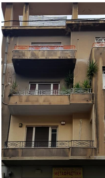
Εικόνα 104: Απόσπασμα πολυκατοικίας του 1934 στη Σόλωνος 130, η χρωματική διαφορά του μπαλκονιού του πρώτου ορόφου, φωτογρ λήψη: Αύγουστος 2018
