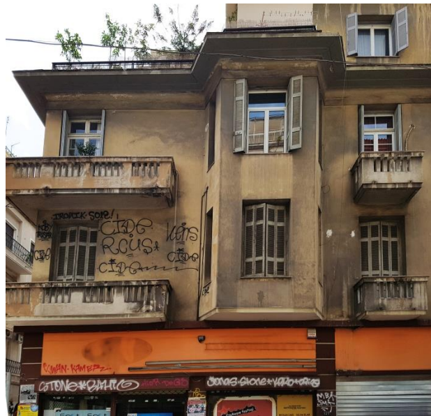
Εικόνα 107: Σόλωνος 127 και Θεμιστοκλέους, διατηρητέο κτίριο με διάχυτη την υλική αποτύπωση της παρακμής στις όψεις του, φωτογρ. λήψη: Αύγουστος 2018
