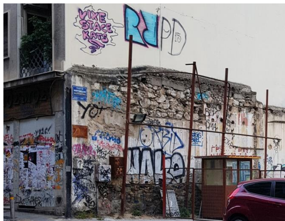
Εικόνα 82: Τα ίχνη του μονώροφου κτίσματος στον υπαίθριο χώρο στάθμευσης στην Σόλωνος με Μαυρομιχάλη, φωτογρ. λήψη: 2018
