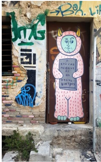
Εικόνα 95: Οδός Σουλίου, διατηρητέο κτίριο σε κακή κατάσταση. Το μήνυμα που μεταφέρει η φιγούρα μοιάζει να συνομιλεί με το γύρω περιβάλλον, φωτογρ. λήψη: 2018
