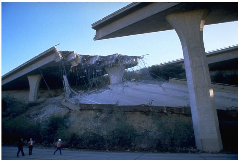
Σχήμα 1.3: Αστοχία της οδικής γέφυρας Interstate 5 στο σεισμό Northridge 1994
