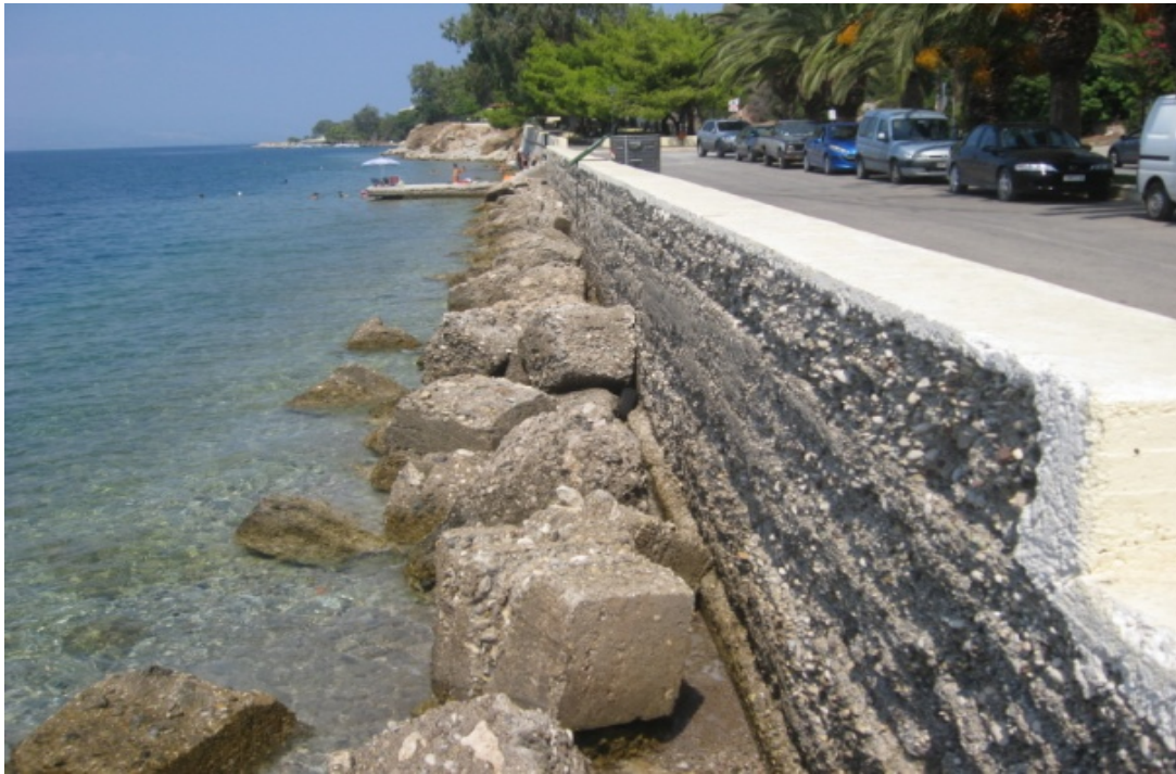
Εικόνα 5-7. Ανεπαρκής θωράκιση του μετώπου του δρόμου
