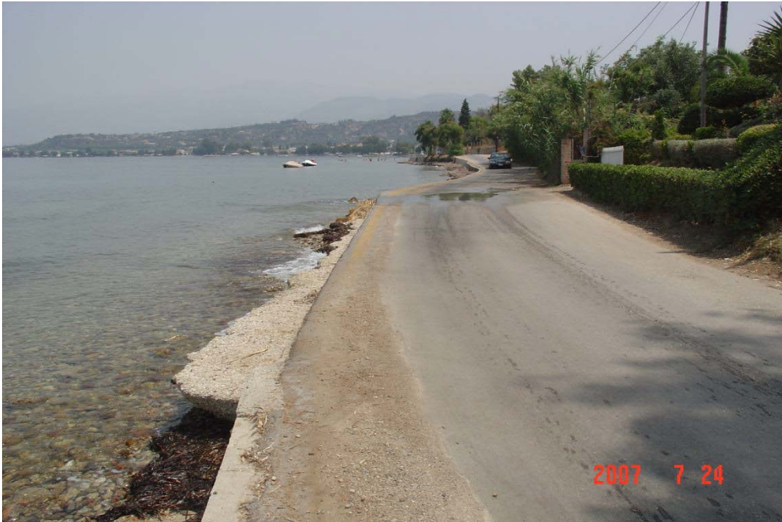
Εικόνα 5-2 Διάβρωση μετώπου του παραλιακού οδικού δικτύου στην περιοχή Χατζίνα (έτος 2007).
