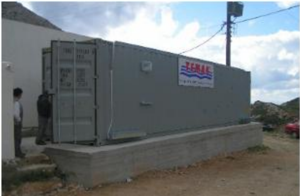
Σχήμα 4.2 Μονάδα αφαλάτωσης στ ν. Σίκινο. (htt1)
