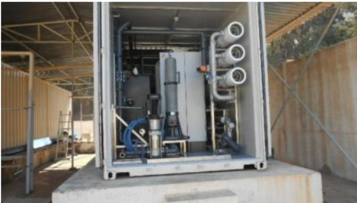
Εικόνα 4.1 Σύστημα αφαλάτωσης σε container (ΜΕΣΟΓΕΙΟΣ Α.Ε.) (htt3)
