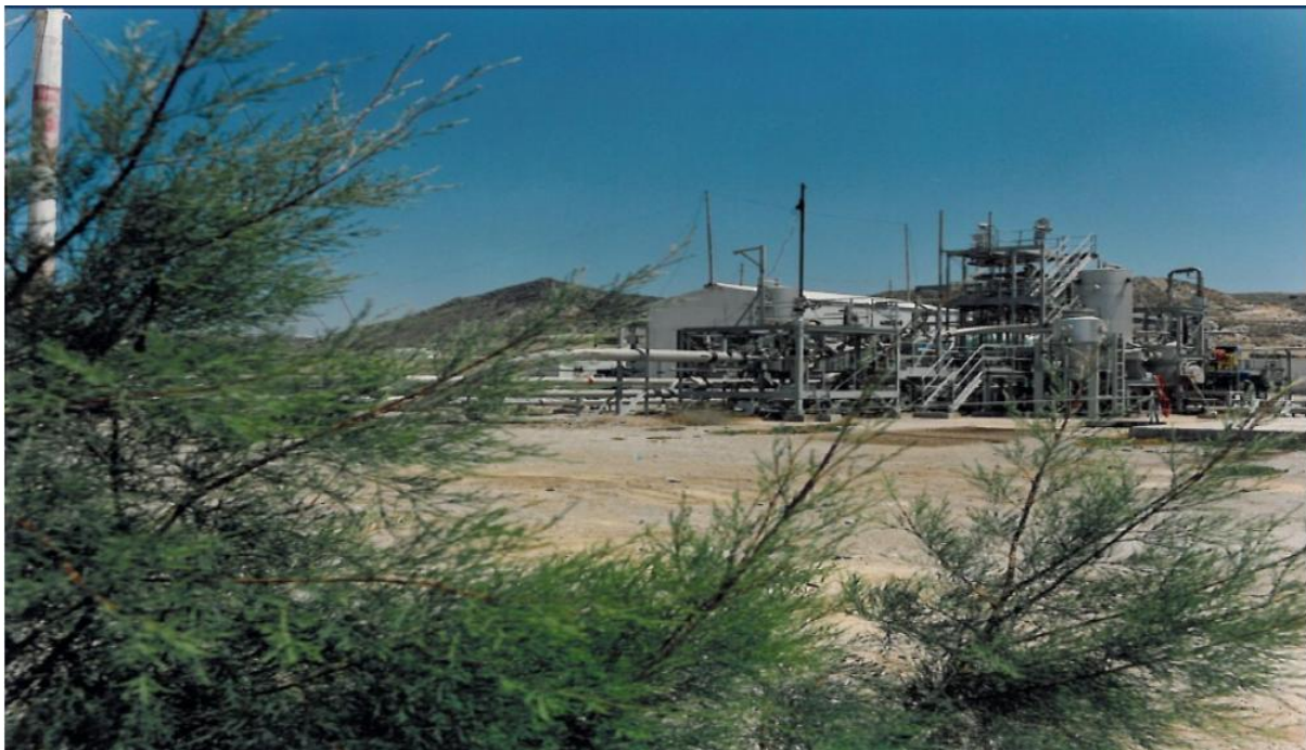
Εικόνα 2.2 Γεωθερμικός σταθμός ηλεκτροπαραγωγής Μήλου. (www)
