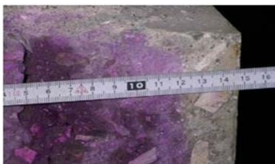
Εικόνα 6: Εκτίμηση βάθους ενανθράκωσης σκυροδέματος μετά από ψεκασμό με διάλυμα φαινολοφθαλεΐνης. Το τμήμα στο οποίο δεν παρουσιάζεται αλλαγή χρώματος (δεξιά) είναι ενανθρακωμένο (βάθος ενανθράκωσης περίπου 3 cm). Το αριστερό τμήμα (χρώμα ροζ-βυσσινί) δεν έχει ενανθρακωθεί.
