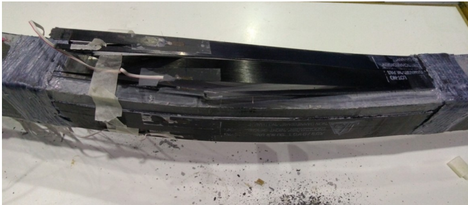
Εικόνα 2.32: Αστοχία πλάγιου και κάτω πέλματος δοκιμίου
