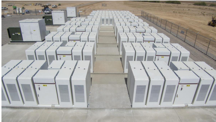
Εικόνα 4.1 Ενδεικτική διάταξη συσσωρευτών ισχύος 10 MW, χωρητικότητας 40 MWh
