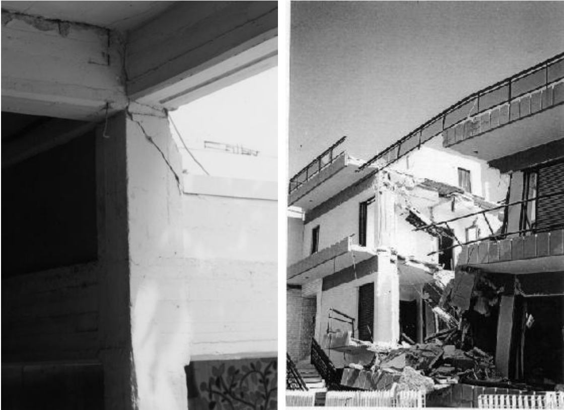
Εικόνα 7.16: αριστερά: διαμητική ρωγμή σε κοντό υποστύλωμα λόγω ανεπαρκούς περίσφιξης και δεξιά:κατάρρευση μεσαίου τμήματος κτηρίου.
