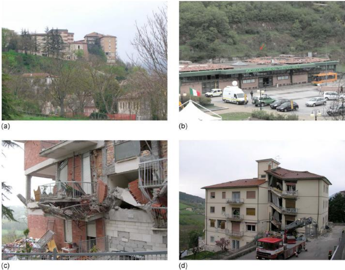
Εικόνα 6.15: Περιπτώσεις όπου οι τοπογραφικές συνθήκες έπαιξαν σημαντικό ρόλο επηρεάζοντας τον κραδασμό των κτηρίων. (a) κτήριο με βλάβες στην τοιχοπλήρωση, (b) ο σταθμός λεωφορείων πίσω από τον οποίο υπάρχει τοίχος αντιστήριξης και ο καταγραφικός σταθμός AQK, (c) κατάρρευση μεσαίου ορόφου στην οδό Gualtieri d' Ocrea και (d) μερική κατάρρευση κτηρίου που θεμελιώνεται σε πλαγιά.
