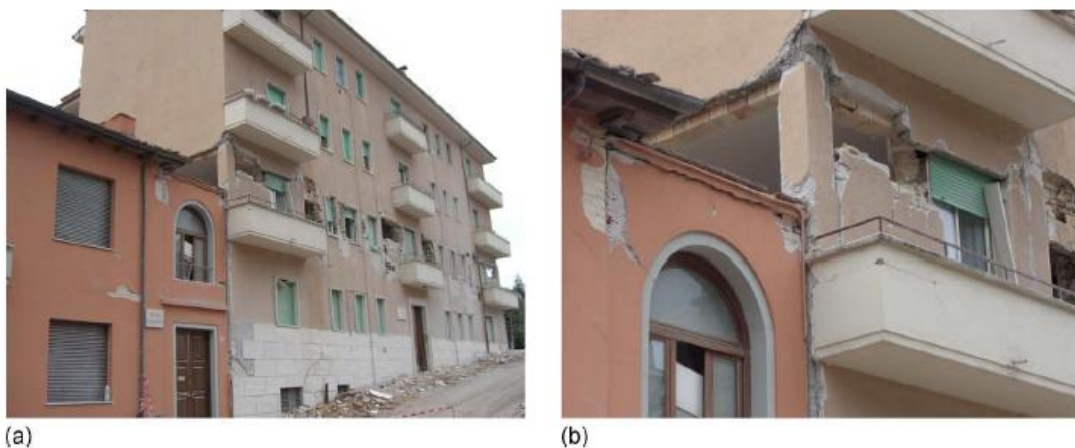
Εικόνα 6.14: Λόγω λανθασμένης κατακόρυφης διαρρύθμισης (με το νέο κτήριο να εφάπτεται στο παλαιότερο χωρίς κοινά υψόμετρα ορόφων) προκλήθηκαν καταστροφές στο νέο κτήριο στα δεξιά.
