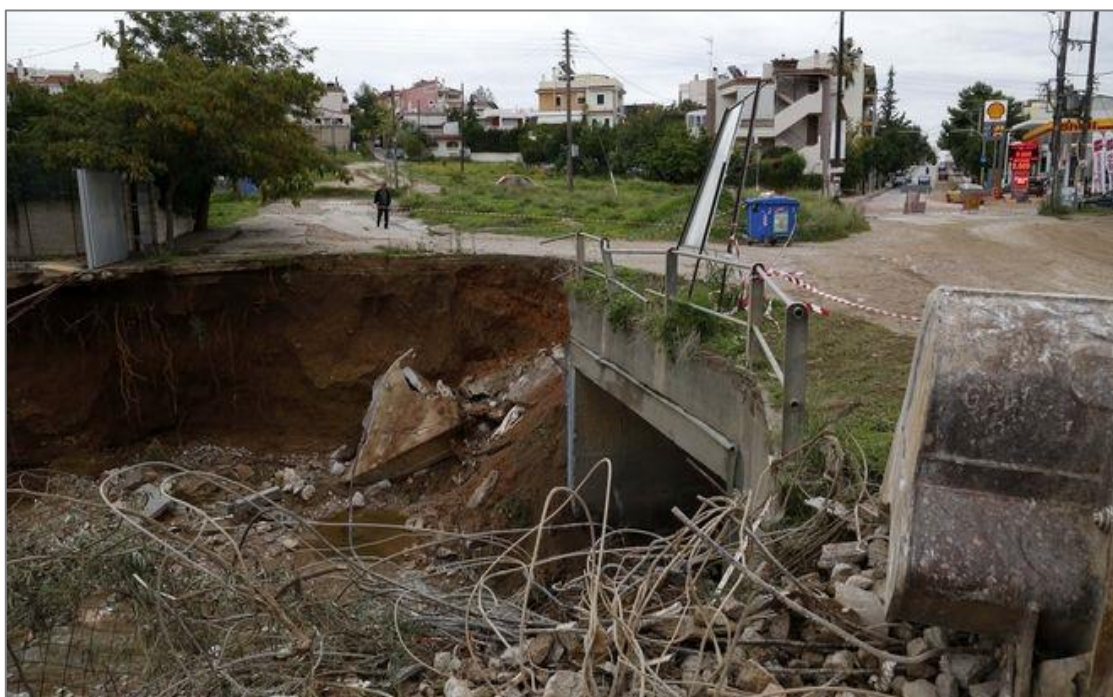
Εικόνα 3-7: Υλικές καταστροφές από την πλημμύρα 22/10/2015
