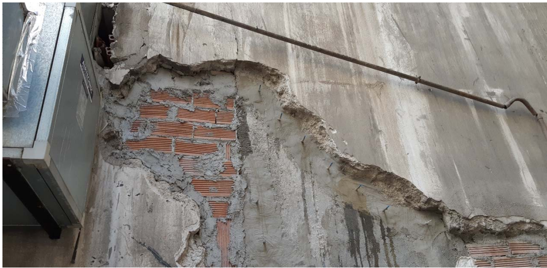
Εικόνα 5 Αστοχία σε τέμνουσα και αποκατάσταση τοιχώματος με ρητίνη
