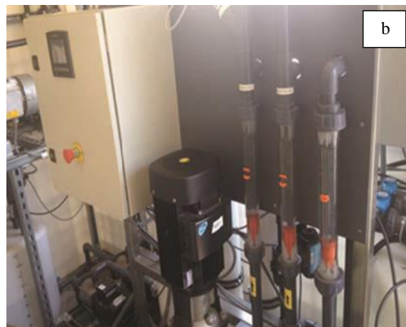
Εικόνα 2.9 (α) Η μονάδα MBR και (β) η μονάδα αντίστροφης ώσμωσης RO (Πηγή: Plevri et al., 2017)
