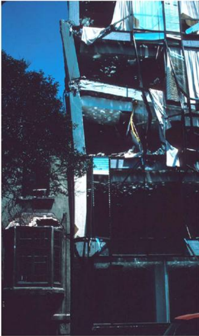
Εικόνα 3-Μεξικό 1985-δυσμενέστερη περίπτωση κρούσης λόγω σεισμού όμορων κτιρίων →κατάρρευση 8-όροφου κτιρίου
