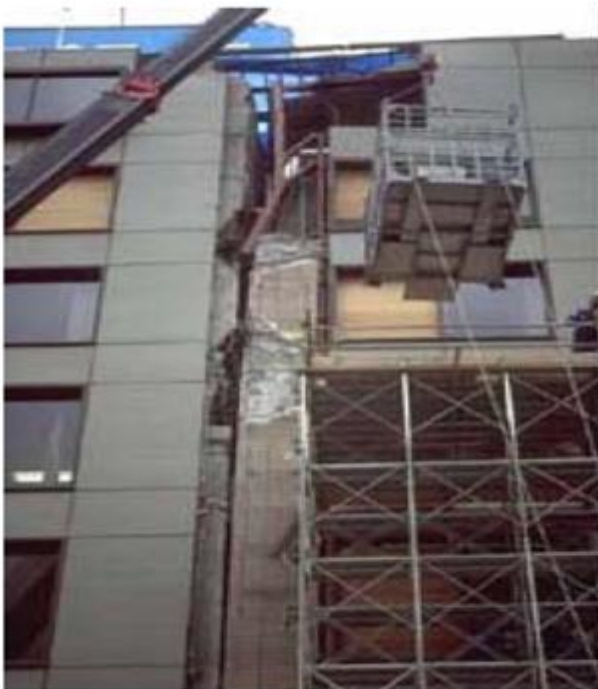
Εικόνα 1-Κομπέ,Ιαπωνία-βλάβες από την κρούση λόγω σεισμού των όμορων κτιρίων
