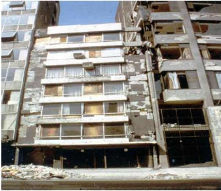
Εικόνα 2-Μεξικό 1985-κρούση λόγω σεισμού όμορων κτιρίων και βλάβες
