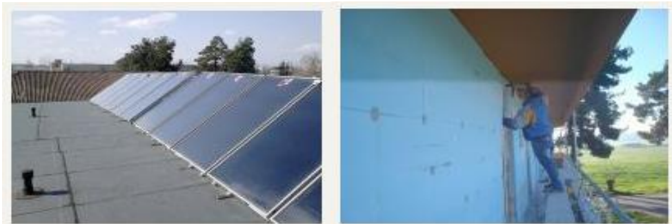
Εικόνα 2.4 110 Πτέρυγα Μάχης (ΠΜ) στην Λάρισα [τοποθέτηση Φ/Β στοιχείων (αρ), θερμομόνωση εξ. τοιχοποιίας (δε)]
