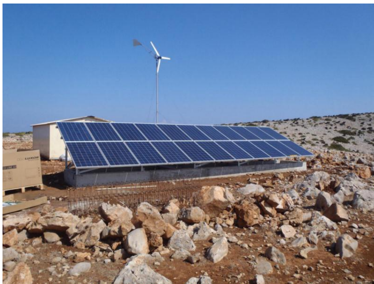
Εικόνα 2.1 Εγκατάσταση φωτοβολταϊκού και αιολικού συστήματος σε Φυλάκιο του Ε.Σ. το 2012, στην μικρονησίδα Καλόλιμνο.
