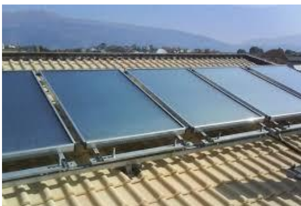
Εικόνα 5.8 Ηλιακοί συλλέκτες συστήματος θερμοσίφωνα με την δεξαμενή νερού εσωτερική, σε ορεινή περιοχή.
