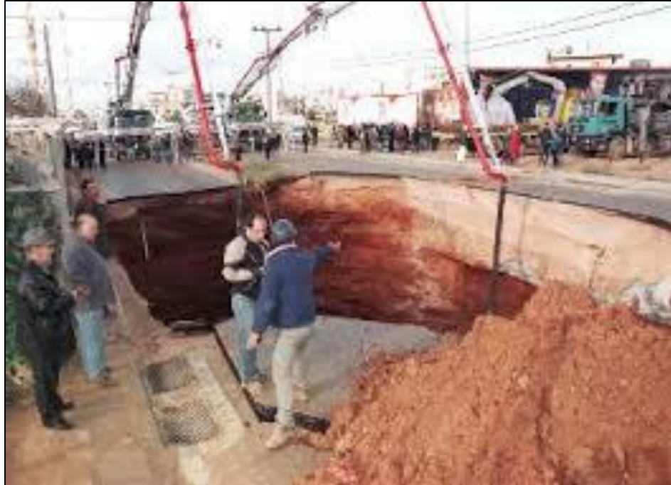
Εικόνα 1. 2. Κατάρρευση οδοστρώματος επί της Λεωφόρου Δουκίσσης Πλακεντίας, λόγω αστοχίας μετώπου υποκείμενης σήραγγας (Πηγή: in.gr).
