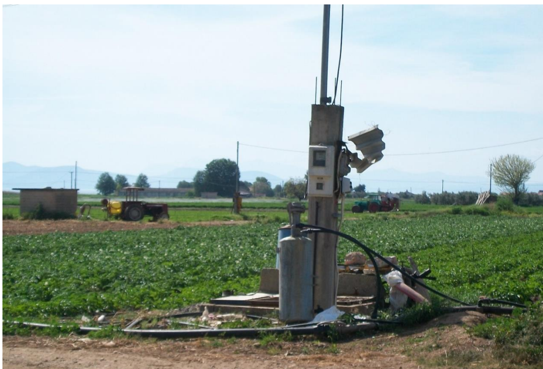
Εικόνα Π17 – Αρδευτική γεώτρηση στη λεκάνη των Ψαχνών.
