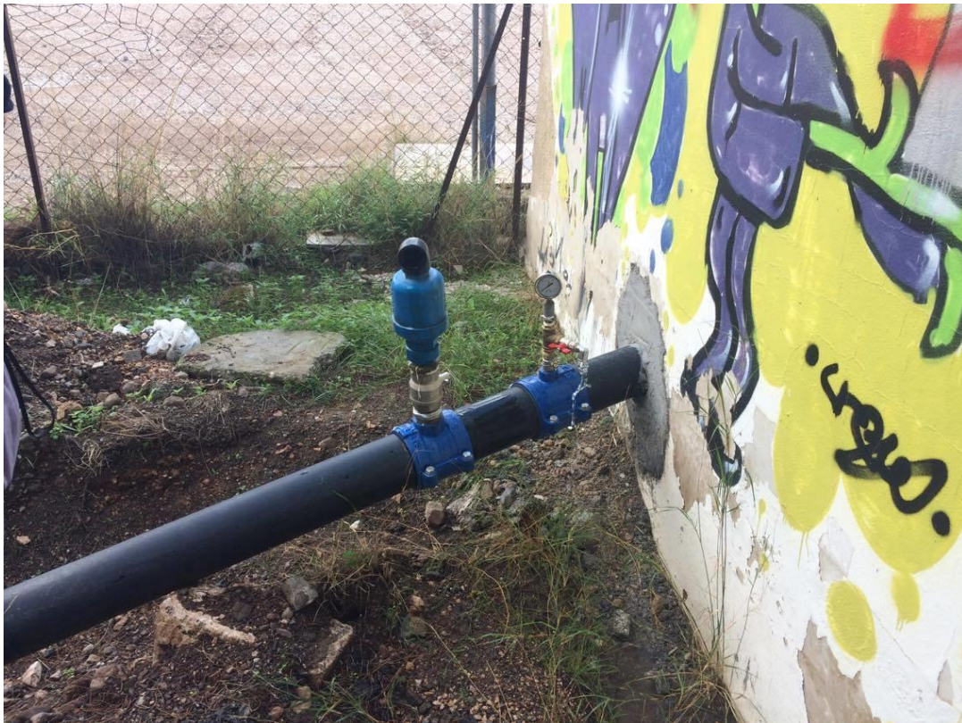
Εικόνα Π4 – Υδρευτική γεώτρηση στην περιοχή του Λουτρακίου.
