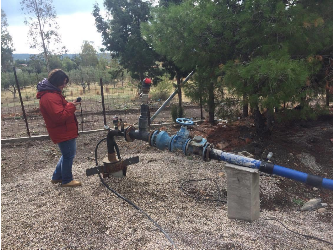
Εικόνα Π3 – Υδρευτική γεώτρηση στην περιοχή του Λουτρακίου.
