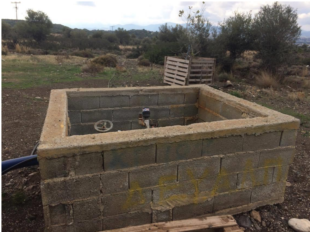
Εικόνα Π6 – Υδρευτική γεώτρηση στην περιοχή του Λουτρακίου.
