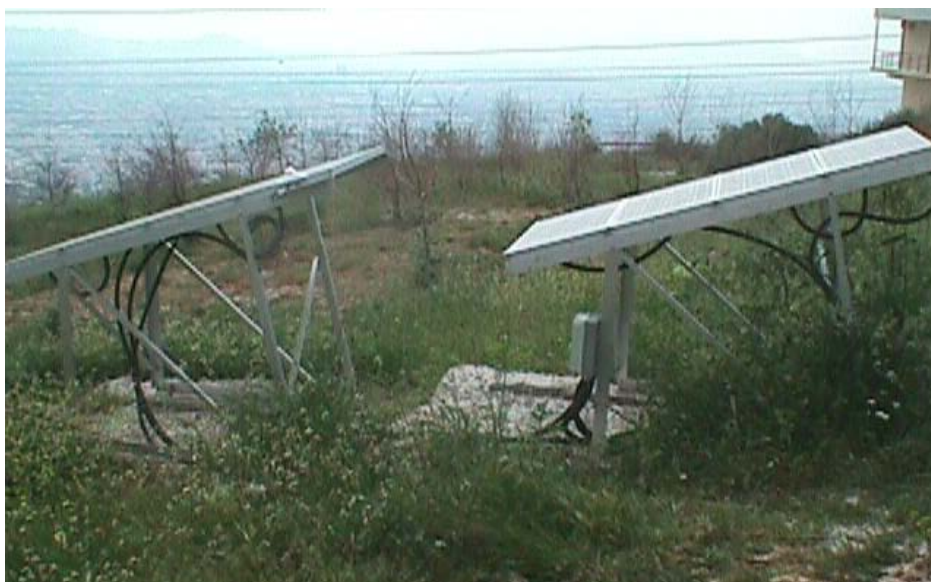
Σχήμα 4.1.1: Φ/Β πλαίσια στην Πεντέλη. Στο αριστερό πλαίσιο φαίνεται το πυρανόμετρο
