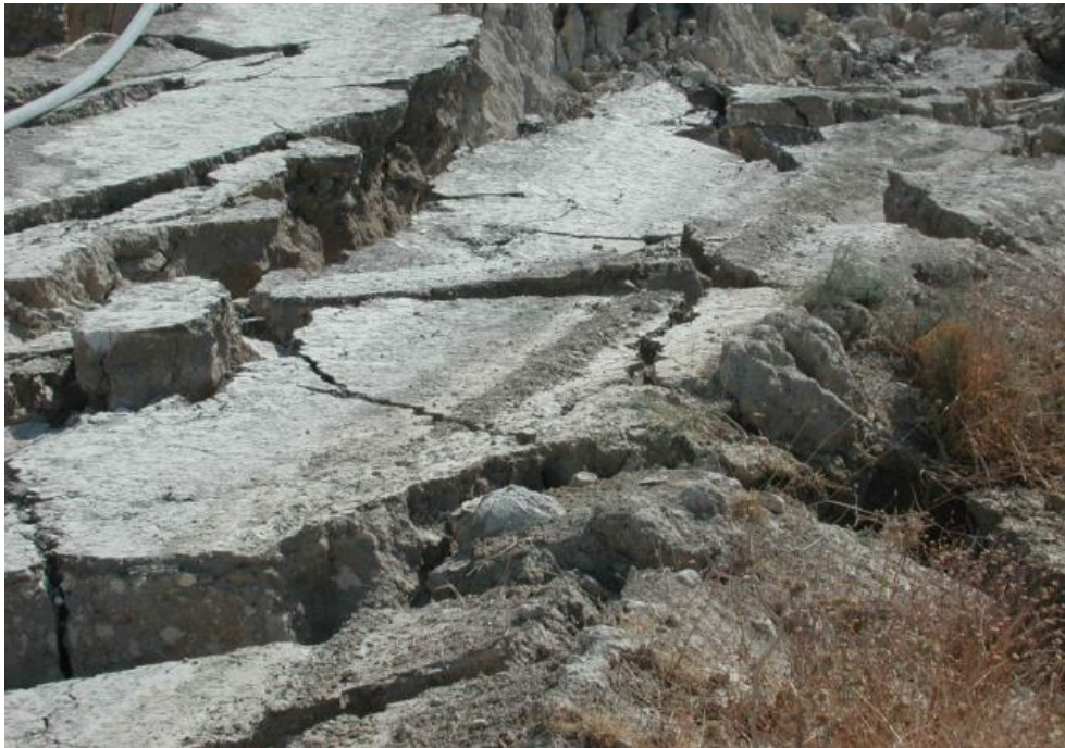
Σχήμα 3.35: Εφελκυστικές ρωγματώσεις και δευτερεύοντες αναβαθμοί ολίσθησης επί των πρανών.
