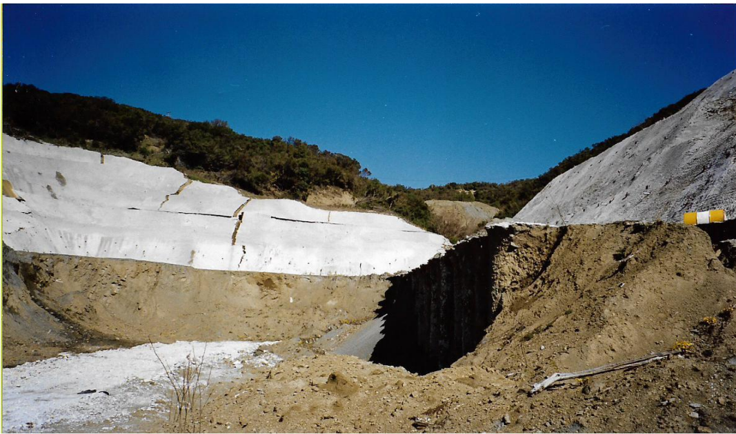
Σχήμα 3.10: Εικόνα της αστοχίας μετώπου και των ζημιών του εκτοξευομένου σκυροδέματος.
