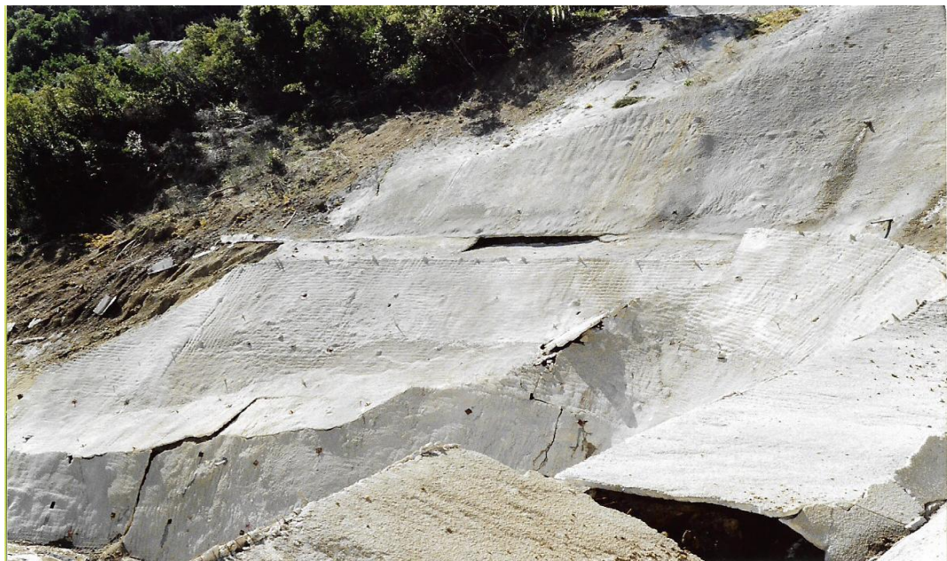
Σχήμα 3.11: Ρηγματώσεις και απόσπαση τεμαχών του εκτοξευομένου σκυροδέματος προστασίας του πρανούς.
