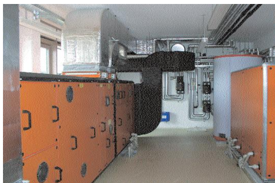
Εικόνα 3.2.5: Σύστημα ψύξης υγρού μέσου DEC εγκατεστημένο στο νέο κτήριο του "Solar Building Innovation Center (SOBIC)" στο Freiburg, στην Γερμανία [3.19].
