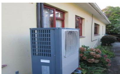
Εικόνα 3.1.7: Αντλία θερμότητας αέρα για θέρμανση νερού (οικιακή χρήση) στην Κίνα.
