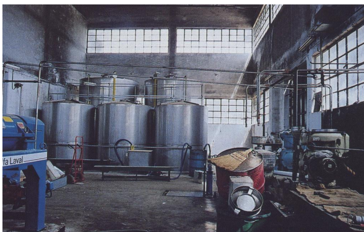
Εικόνα 1.2. Δεξαμενές αποθήκευσης ελαιολάδου σε ελαιοτριβείο στα Χανιά
