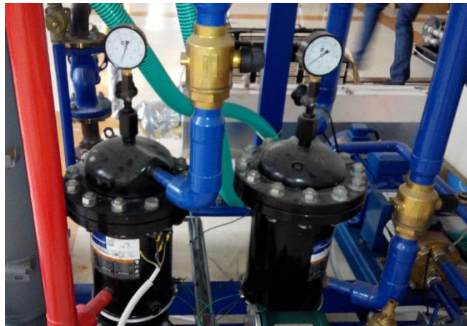
Τελική διαμόρφωση εκτονωτών της μηχανής ORC
