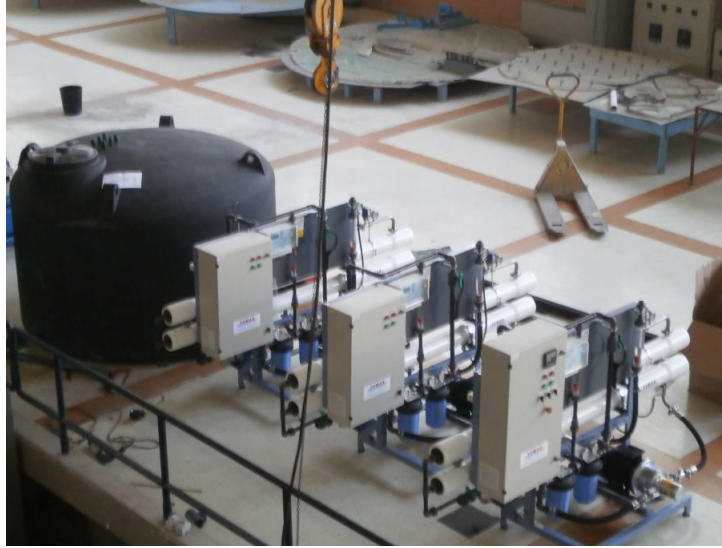
Το συνολικό σύστημα αφαλάτωσης εγκατεστημένο στο εργαστήριο
