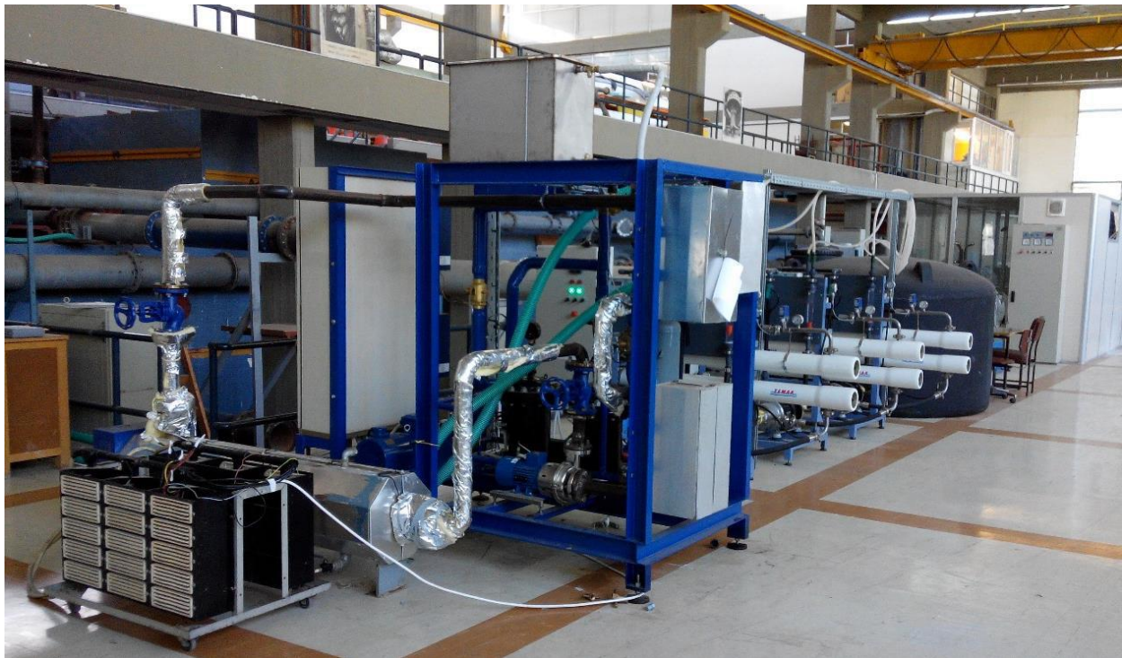
Το εγκατεστημένο υβριδικό σύστημα αφαλάτωσης στο εργαστήριο Υδροδυναμικών Μηχανών του Εθνικού Μετσοβίου Πολυτεχνείου
