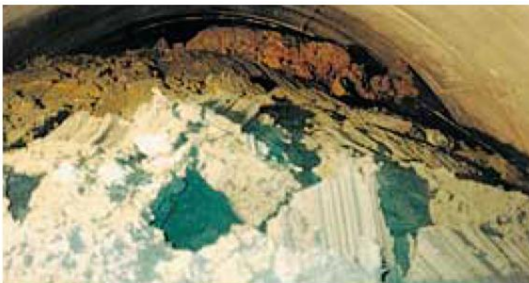
Εικόνα 2.1: Κατάρρευση μετώπου της σήραγγας του Vasto [14].
