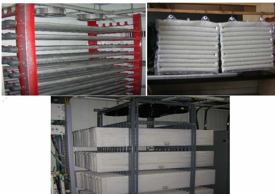
Σχήμα 5.8.1 : Συσκευασίες PCM (πλάκες και κύλινδροι) που χρησιμοποιούνται σε τηλεπικοινωνιακά κουβούκλια [30].
