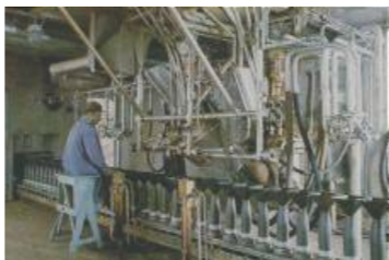
Εικ27 : Εξοπλισμός ΠΥΡΚΑΛ
