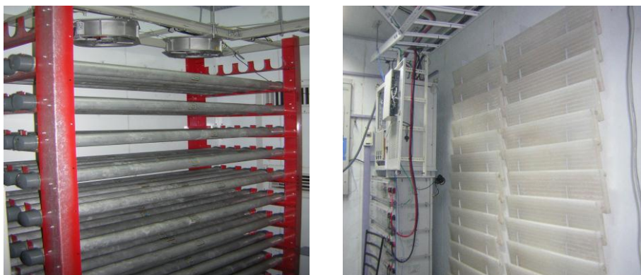
Σχήμα 3.10: Εφεδρεία AC για καταφύγιο τηλεπικοινωνιών σε σωλήνες αλουμινίου (αριστερή εικόνα), εγκατεστημένο PCM σε καταφύγιο τηλεπικοινωνιών για εφεδρεία AC στους 29°C (δεξιά εικόνα) [23].
