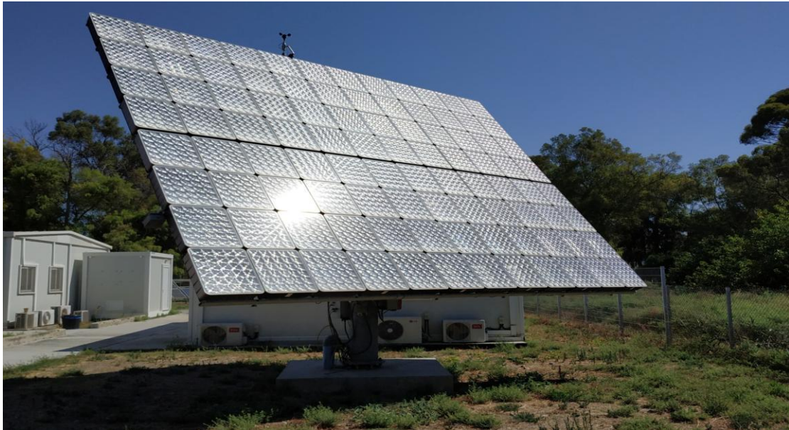
Σχήμα 2.10 Φωτοβολταϊκό σύστημα παρακολούθησης του ήλιου
