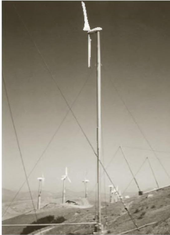
Σχήμα 2-2: Χαλύβδινοι σωληνωτοί πυλώνες ανεμογεννητριών με καλώδια (Πηγή:Μεταπτυχιακή Εργασία Αικατερίνας Η. Νταιφιώτη)
