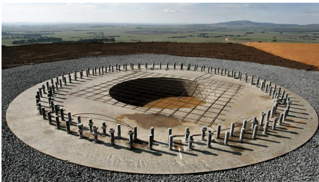
Σχήμα 2-25: Σκυροδετημένο θεμέλιο με τα αγκύρια να προεξέχουν ώστε να τοποθετηθεί το τεμάχιο βάσης (Πηγή: www.riley-group.com )
