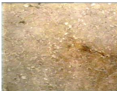
Οξειδία & υδροξείδια σιδήρου (φλέβες) στην περικρυσταλλικά ρηγματωμένη περιοχή του μαρμάρου, x25
