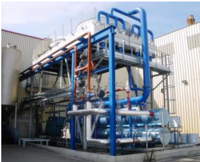
Εικόνα 1.7.10 : Το σύστημα της Enertime ικανότητας 1MW
