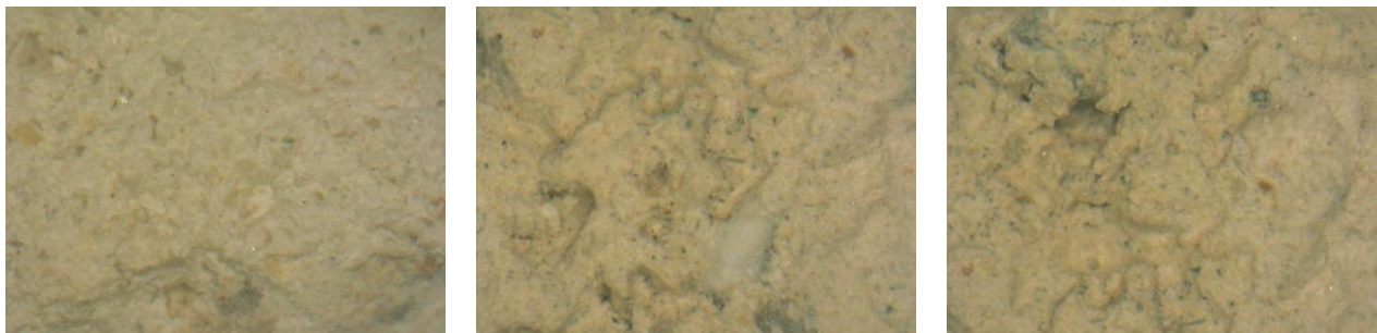
D11_p: Επίχρισμα θέσης 1 1 ου ορόφου x50, x50, x50
