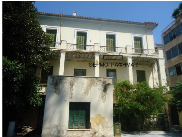
Εικόνα 4.1.2.3 όπου σημειώνεται η περιοχή από όπου ελήφθη το θερμογράφημα 9
