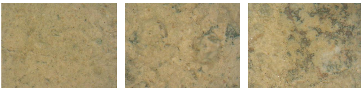
D12_p: Επίχρισμα θέσης 2 1 ου ορόφου x50, x50, x50
