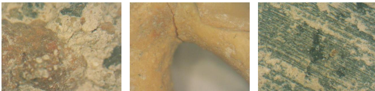
D22_p: Επίχρισμα θέσης 2 2 ου ορόφου x50, x50, x50
