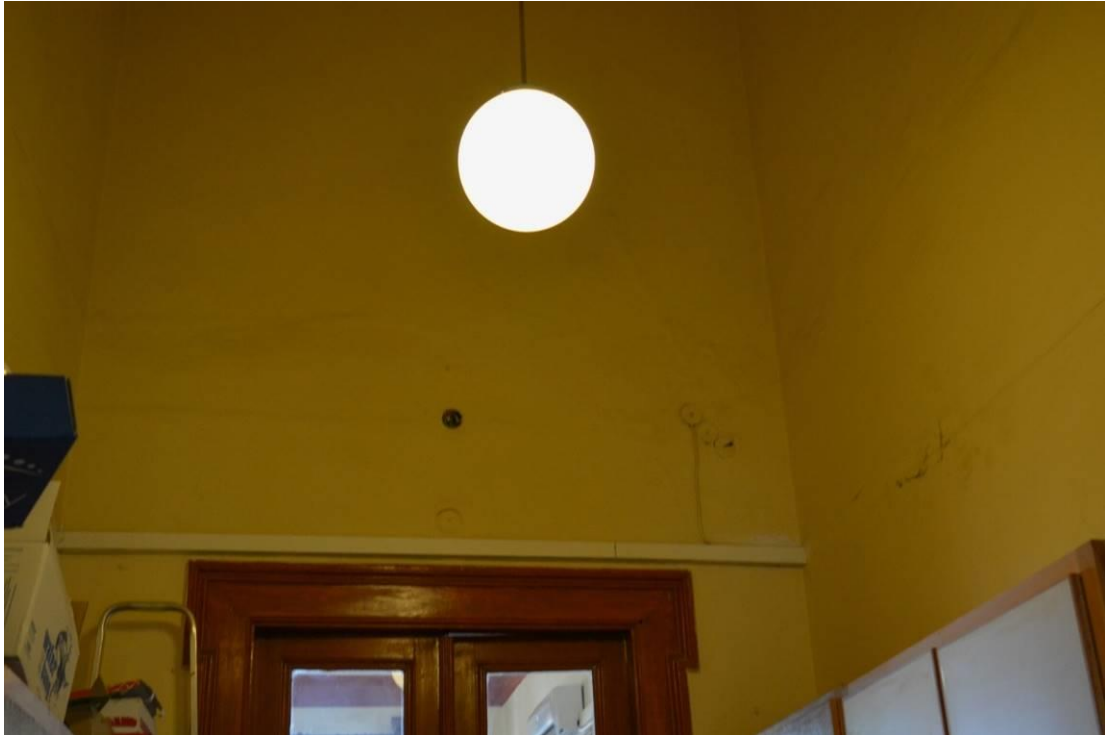
Εικόνα 12: Φωτιστικό σώμα με λαμπτήρα αλογόνου (halogen) 53 W
