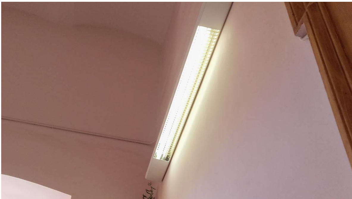
Εικόνα 8: Επίτοιχα φωτιστικά σώματα με λαμπτήρες T8 ισχύος 58W
