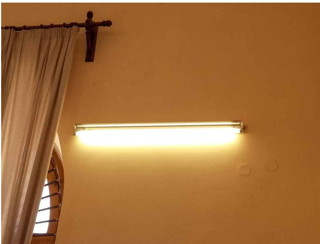
Εικόνα 11: Φωτιστικό σώμα όπου ο ένας εκ των δύο λαμπτήρων 36 W δεν λειτουργεί
