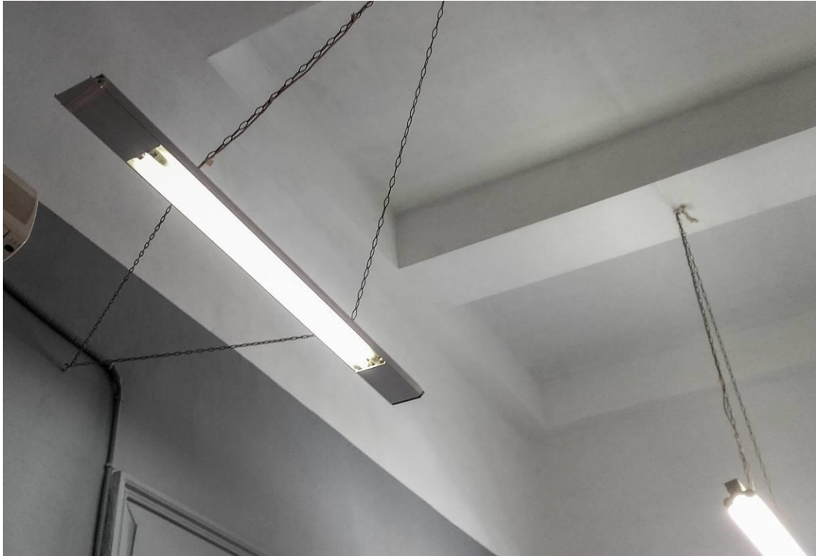
Εικόνα 7: Φωτιστικά σώματα με λαμπτήρες T8 ισχύος 58W με ανάρτηση από την οροφή
