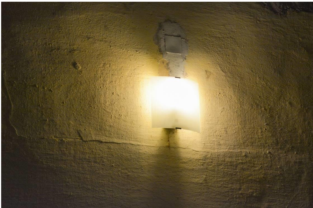
Εικόνα 16: Φωτιστικό σώμα διαδρόμου με γαλακτερό διαχύτη
