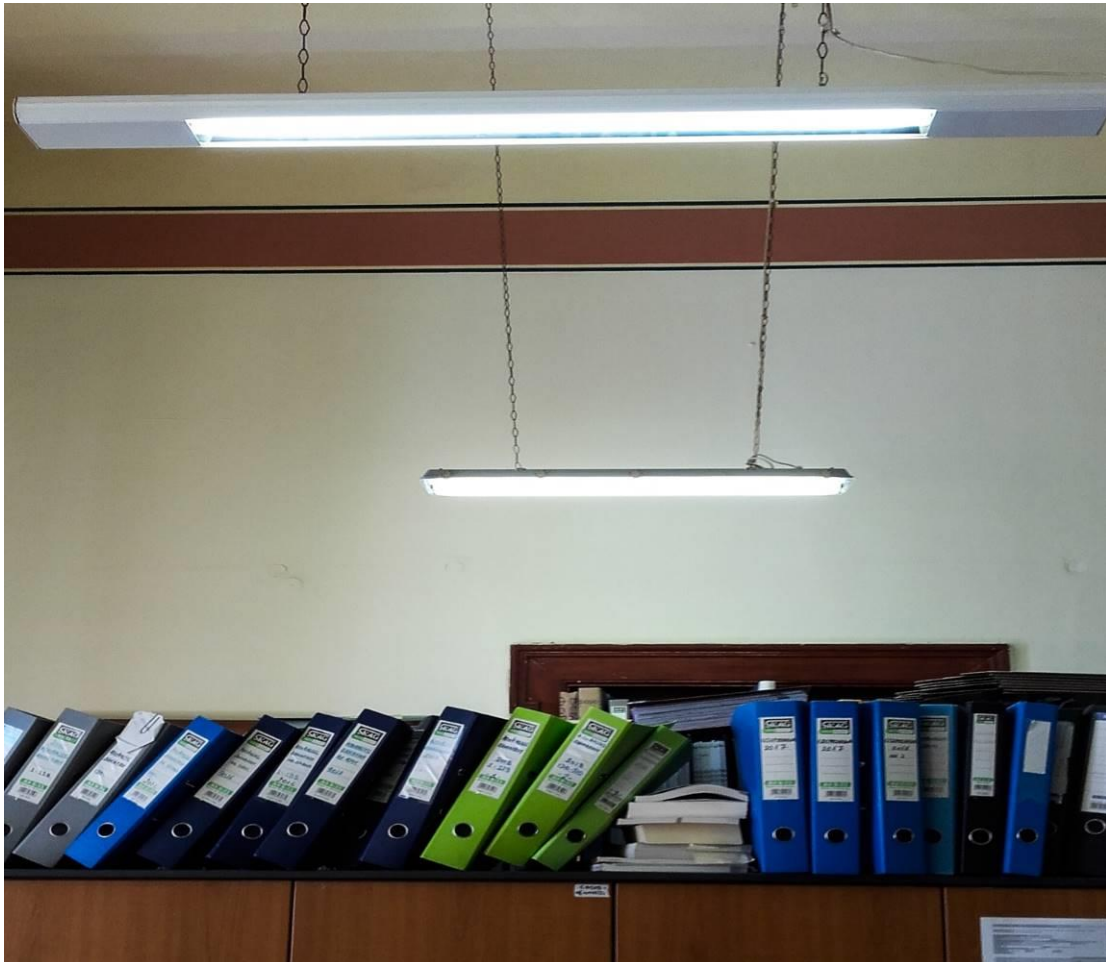
Εικόνα 18: Φωτιστικά σώματα T8 τοποθετημένα πάνω από ράφια
