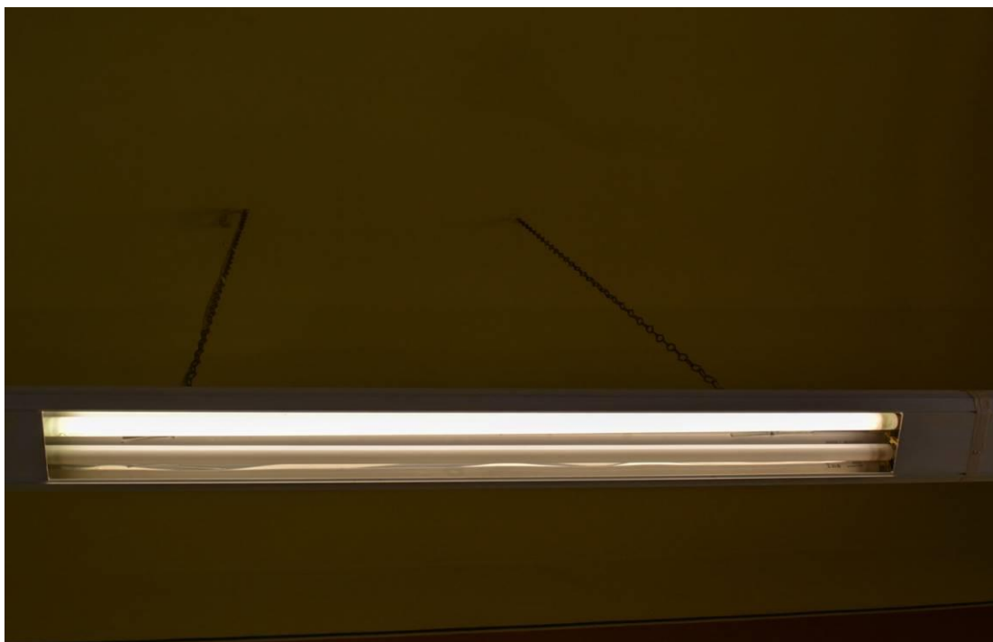
Εικόνα 10: Φωτιστικό σώμα όπου ο ένας εκ των δύο λαμπτήρων 58 W δεν λειτουργεί
