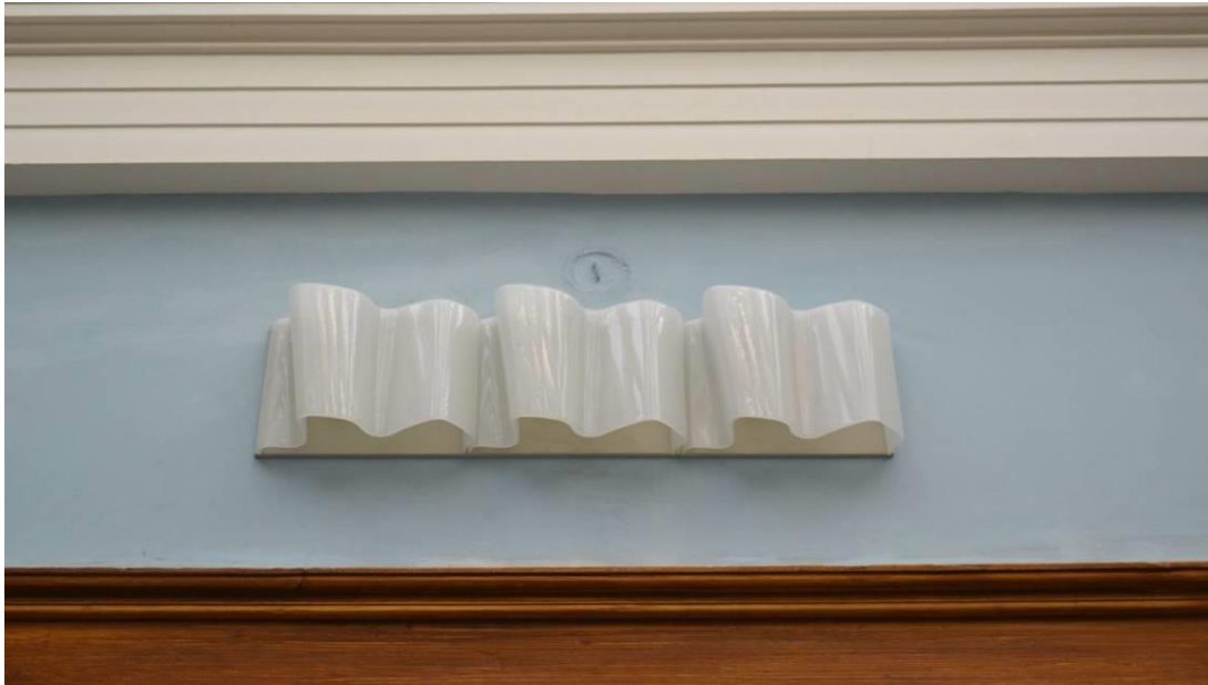
Εικόνα 14: Φωτιστικό σώμα διαδρόμου με γαλακτερό διαχύτη
