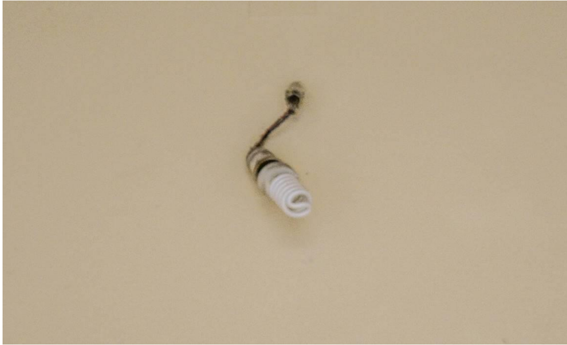
Εικόνα 20: Λαμπτήρας CFL 23 W τοποθετημένος πάνω από είσοδο χώρου
