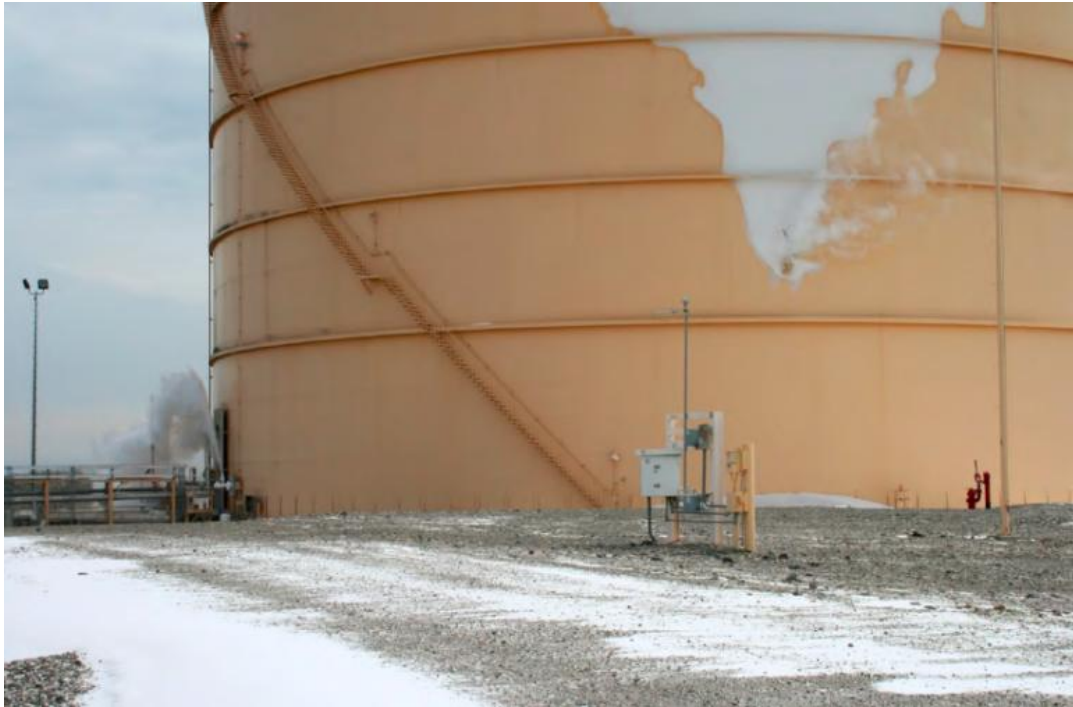
Εικόνα 49: Διαρροή LNG από οπή στην δεξαμενή ξηράς της εγκατάστασης LNG στην ανατολική Ουάσινγκτον [93]
