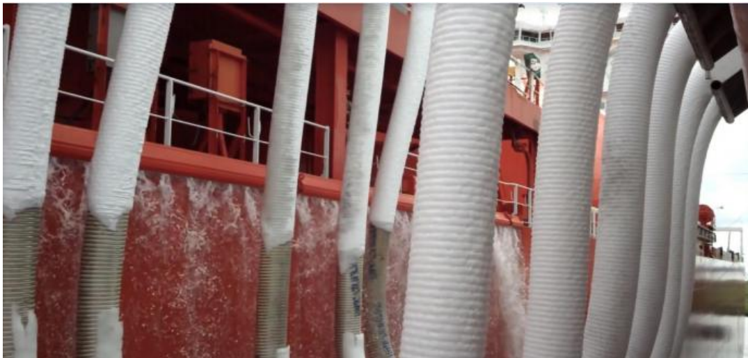
Εικόνα 42: Ροή νερού κάτω από τους σωλήνες για αποφυγή ζημιάς του πλοίου σε περίπτωση διαρροής LNG [92]
