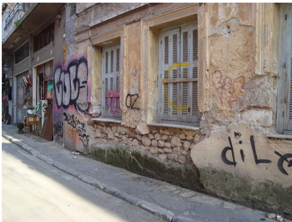
Φωτ.5 : Κατάρρευση επιχρίσματος και απόπλυση του κονιάματος σε τμήμα του ισογείου.
