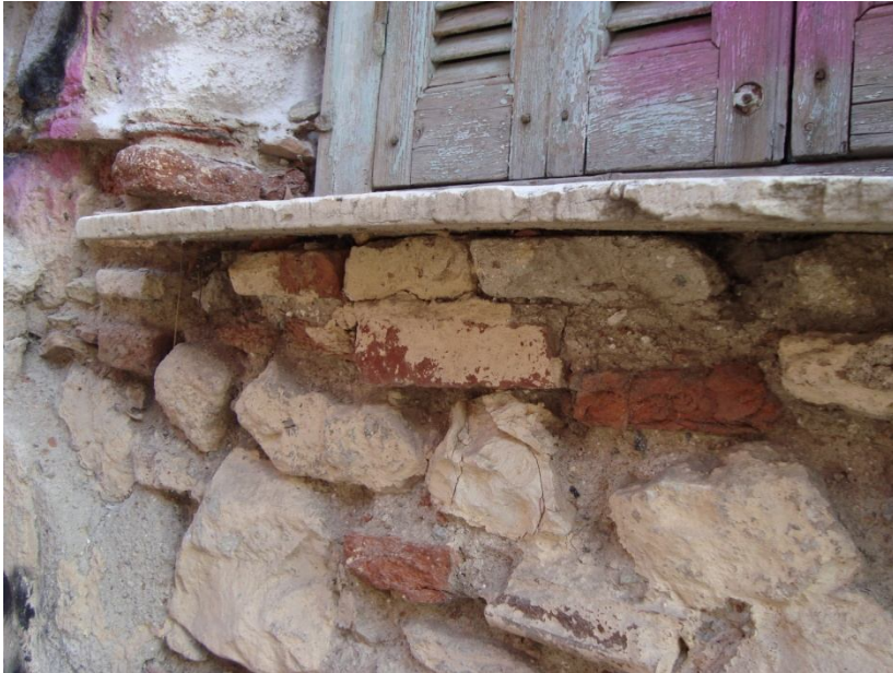
Φωτ.6, 7 : Λεπτομέρειες της λιθοδομής όπου φαίνεται ο βαθμός απόπλυσης του κονιάματος.
