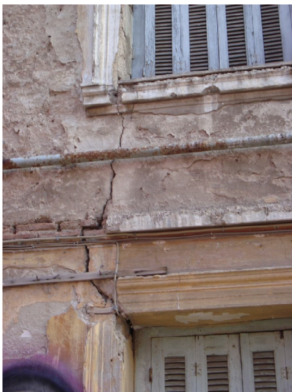
Φωτ.4 : Άνοιγμα ρωγμής σε ένα από τα υπέρθυρα του ισογείου.
