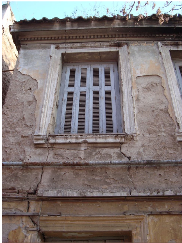
Φωτ.2, 3 : Κατάρρευση των επιχρισμάτων και κατακόρυφες ρωγμές στα υπέρθυρα.
