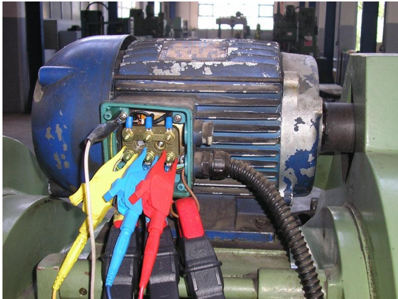
Σχήμα 4.2: Σύνδεση αισθητήρων στο ακροκιβώτιο ηλεκτροκινητήρα.
