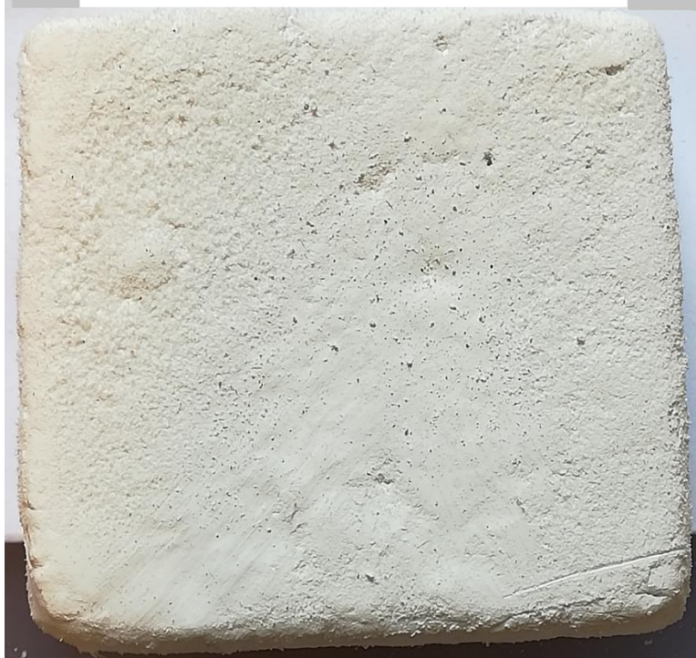
Εικόνα XIII: Διαβρωμένες επιφάνειες δοκιμίων του χρώματος E.
