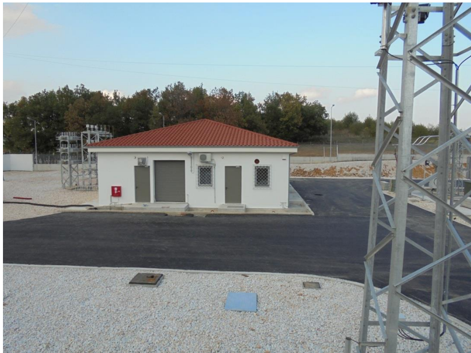
Φωτογραφία 4: Υποσταθμός ρεύματος
