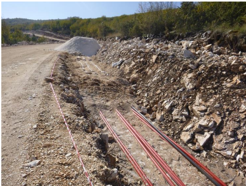
Φωτογραφία 2: Κανάλι καλωδίων/ Προστασία με άμμο καλωδιώσεων
