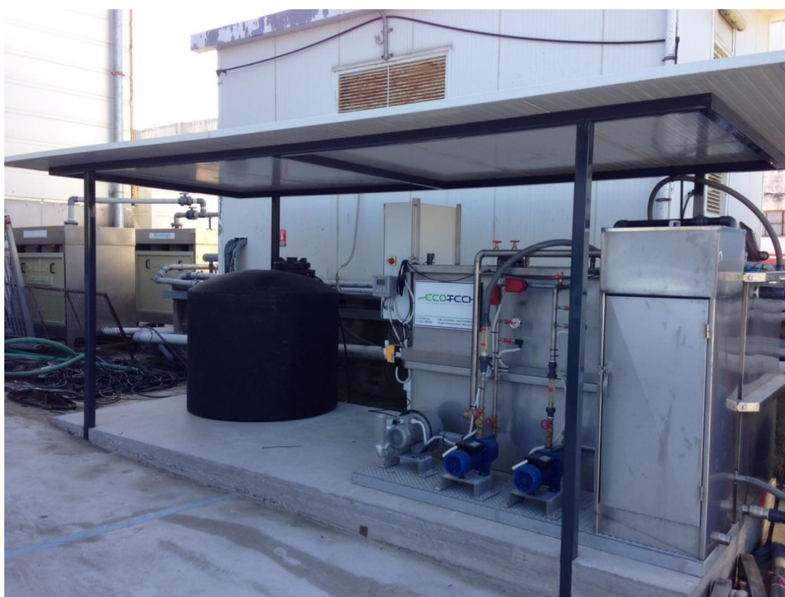
Εικόνα 4. Πιλοτική μονάδα εγκατεστημένη στην βιομηχανία τροφίμων
