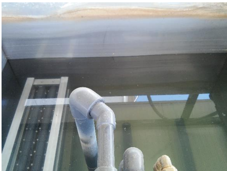
Εικόνα 29. Module Μεμβρανών εντός της δεξαμενής αερισμού
