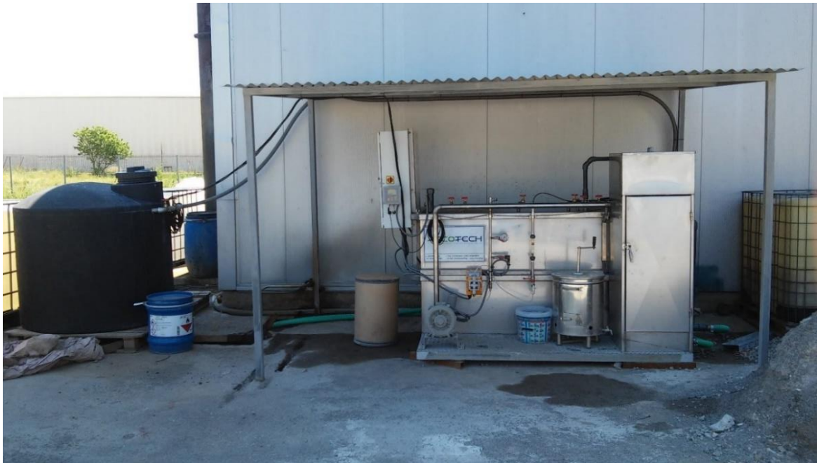
Εικόνα 11. Πιλοτική μονάδα εγκατεστημένη στην βιομηχανία βαφής – φινιρίσματος
