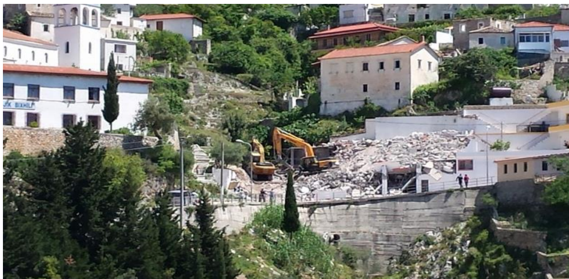
Εικόνα 1: Κατεδάφιση αυθαίρετων κτισμάτων στο χωριό Δρυμάδες στη Χιμάρα το 2016. Η Αλβανική νομοθεσία προβλέπει κατά την διάρκεια εξέτασης της αίτησης το αυθαίρετο κτίσμα δεν κατεδαφίζεται αλλά εάν η αίτηση απορριφθεί τότε το κτίσμα κρίνεται προς κατεδάφιση..(Himara.gr, 2016)
