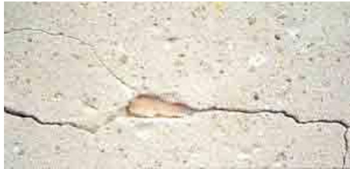
Εικόνα 4.3 Εμφάνιση ρωγμής σε σκυρόδεμα
