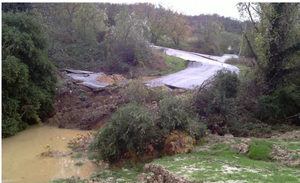
Εικόνα 7.12 "Διάρρηξη του κεντρικού δρόμου του χωριού "Μουζακαίοι"" (Τσίγκα & Μάλλη, 2013)
