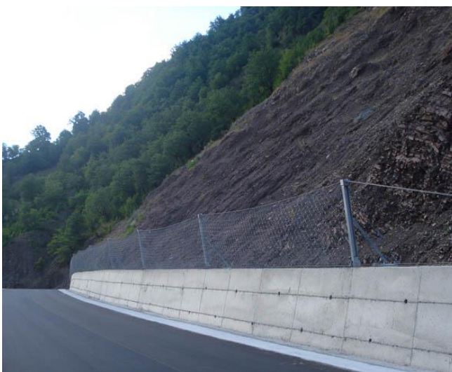
Εικόνα 5.7 “Απεικόνιση φράχτη ανάσχεσης κατολισθήσεων” (Terra Nova, 2016)
