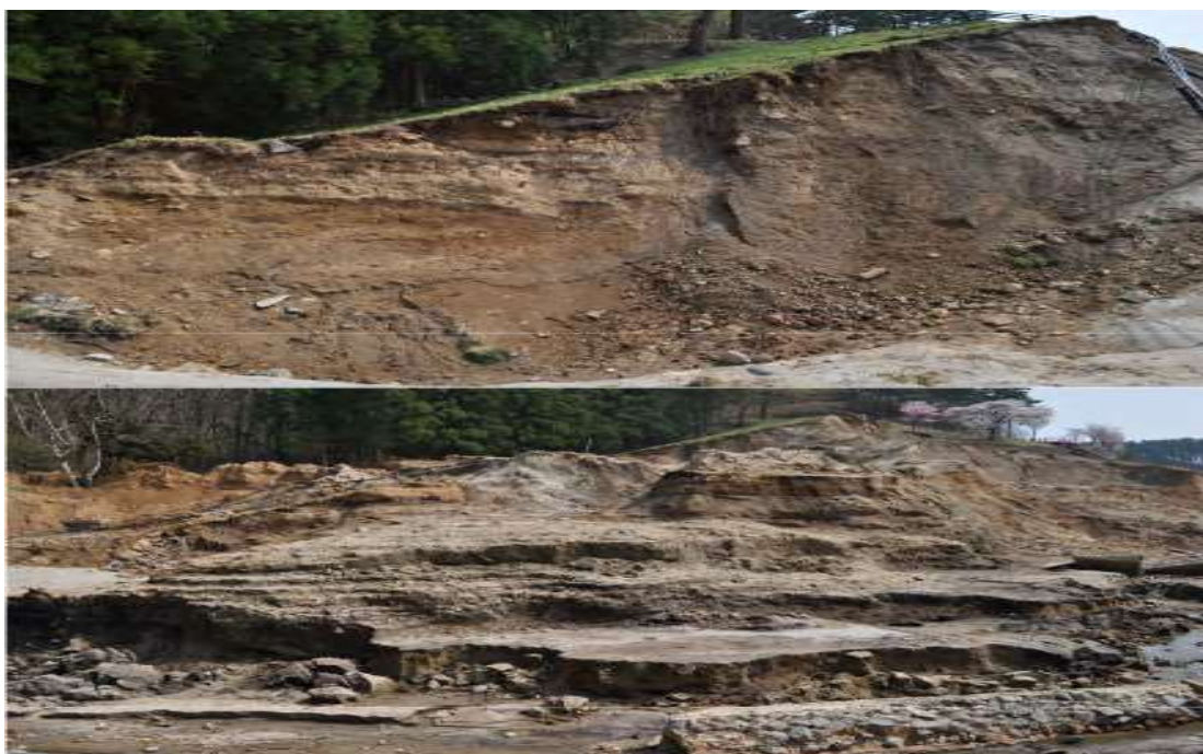
Εικόνα 4.13 Αστοχία στο σώμα του φράγματος (πάνω) και στο δεξιό του αντέρεισμα (κάτω)
