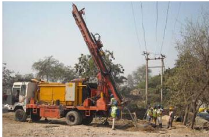
Σχήμα 3.15 Πραγματοποίηση τσιμεντενέσεων υπό κλίση 27^\circ σε έργο του Μετρό στην Kuala Lumpur
