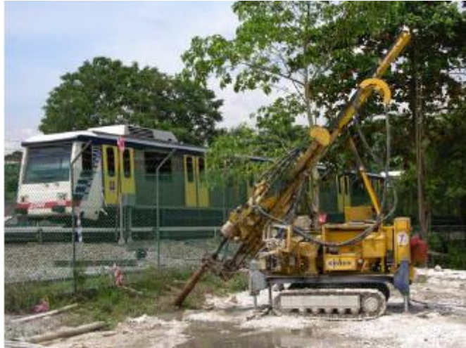
Σχήμα 5.15 Εφαρμογή ενεμάτωσης υπό πίεση κάτω από το σιδηρόδρομο για περιορισμό των καθιζήσεων (V. Raju, I. Yee, 2006)
