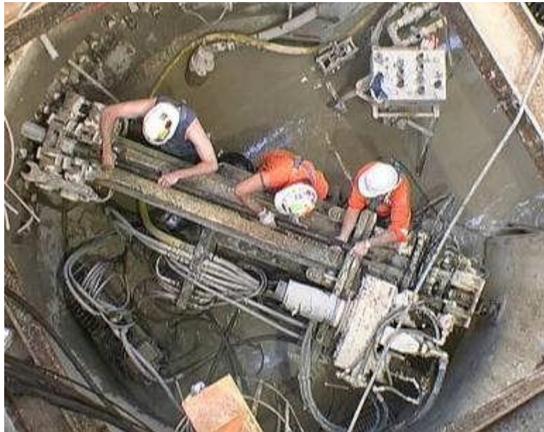
Σχήμα 2.9 Γεωτρύπανο εγκατεστημένο στον πυθμένα φρέατος για την τοποθέτηση σωλήνων στα πλαίσια κατασκευής Μετρό στην πολιτεία της Νεβάδα
