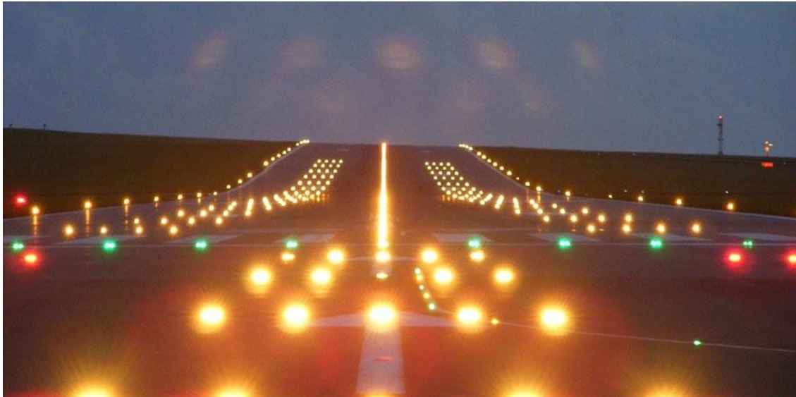
Εικόνα 47 Φωτισμός διαδρόμων αεροδρομίου τμήμα Α
