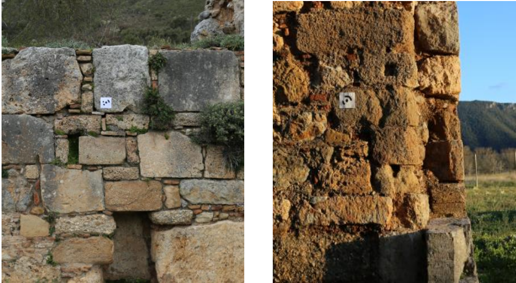
Εικόνα 2.11: Φωτοσταθερά στους τοίχους του Ναού και της πύλης
