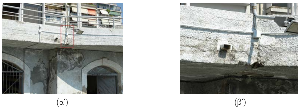
Σχήμα 4.21: (α) Γενική όψη της ρωγμής NO2. (β) Μεγέθυνση στη ρωγμή NO2.
