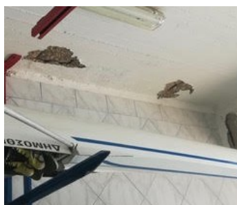
Σχήμα 4.41: Φθορές και βλάβες στην οροφή της ενδιάμεσης πτέρυγας (προς τη θάλασσα).
