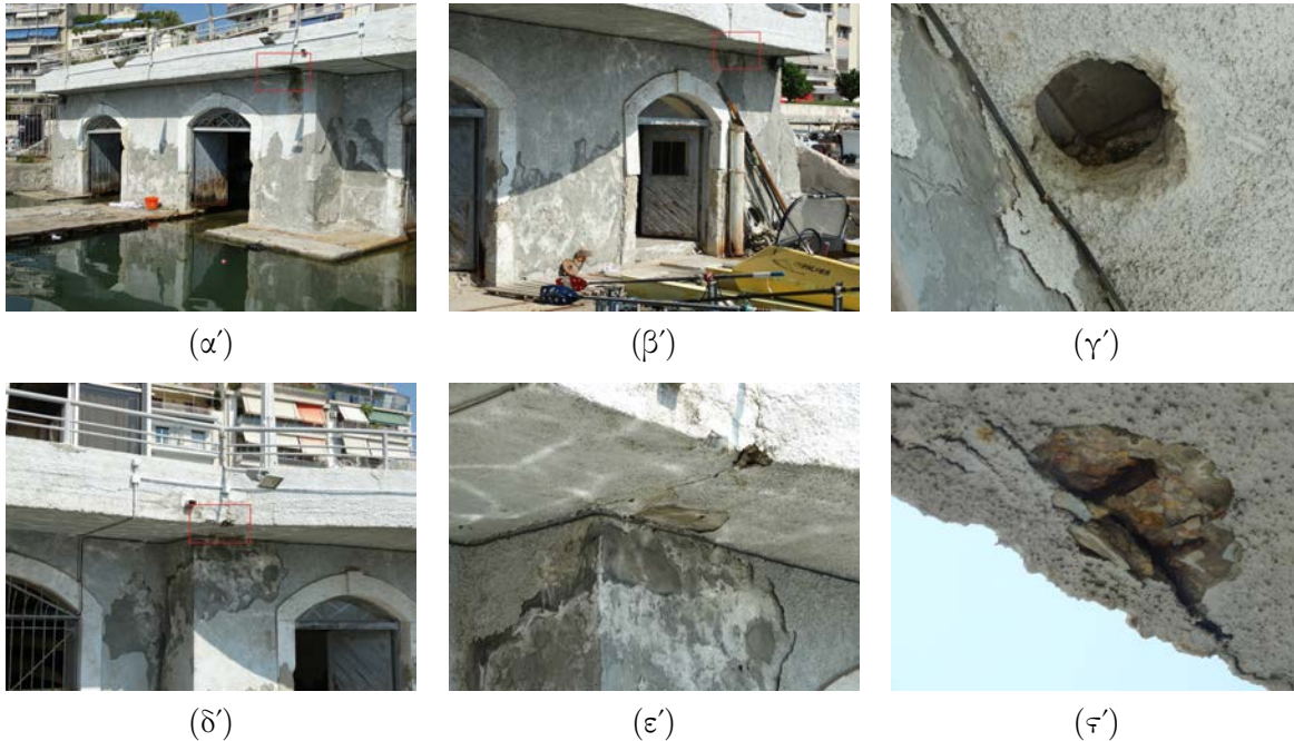
Σχήμα 4.43: (α'), (β'), (γ') Οπές στην πλάκα του μπαλκονιού. (δ'), (ε'), (ς') Ρωγμή και αποκάλυψη οπλισμού στην πλάκα του μπαλκονιού.
