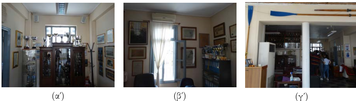
Σχήμα 4.44: (α'), (β'), (γ') Απουσία βλαβών στην οροφή του ανωγείου.
