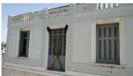
Σχήμα 4.8: Φθορές στα διακοσμητικά στοιχεία της πρόσοψης του ορόφου.
