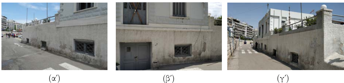
Σχήμα 4.7: (α'), (β'), (γ') Τοπικές αποκολλήσεις επιχρισμάτων στο επίπεδο του ισογείου. Είναι εμφανής η ανοδική και η καθοδική υγρασία στην επιφάνεια της λιθοδομής.
