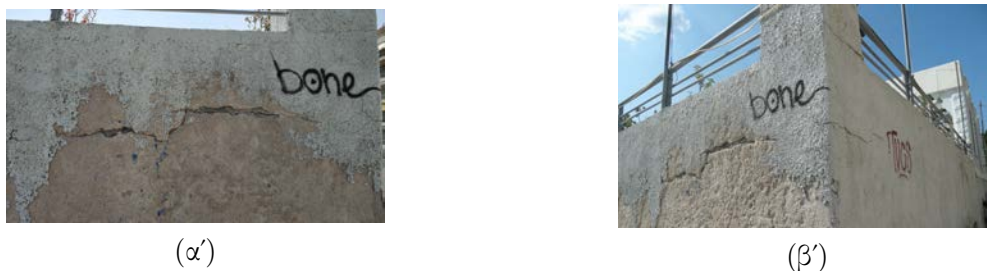
Σχήμα 4.11: (α) Μεγέθυνση ρωγμής ΑΟ3. (β) Η ρωγμή ΑΟ3 ως συνέχεια της ρωγμής ΒΟ1.
