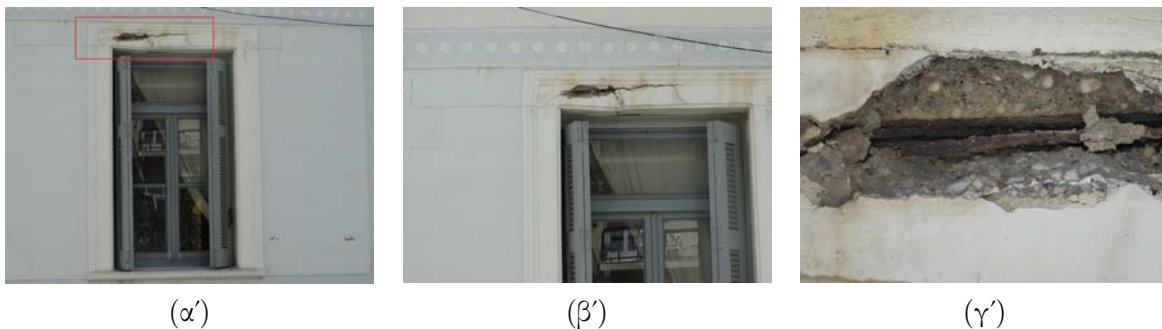
Σχήμα 4.5: (α') Ρωγμή ΒΟ6. (β'), (γ') Σταδιακή μεγέθυνση της ρωγμής.
