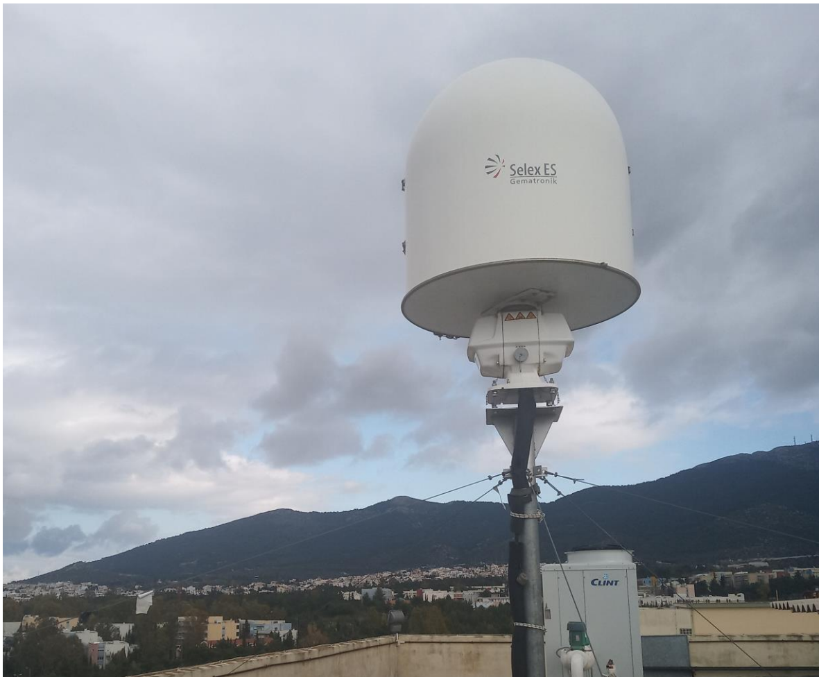
Σχήμα 2-3: Η κεραία του εγκατεστημένου Rainscanner στο κτήριο του εργαστηρίου υδρολογίας της σχολής Πολιτικών Μηχανικών
