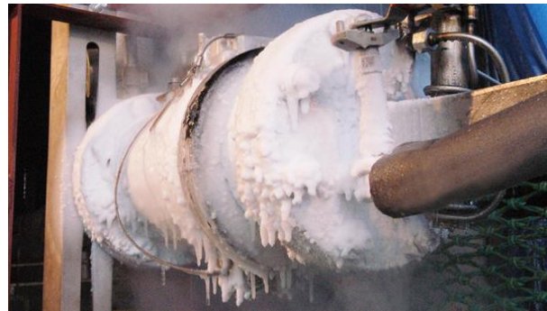
Εικόνα 3-1. Κρυογονικό ατύχημα σε εξοπλισμό LNG.
