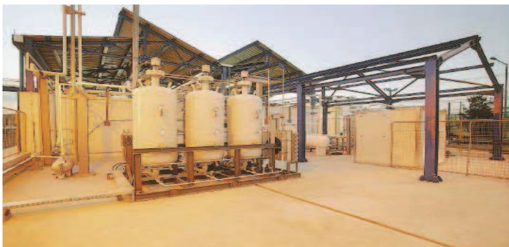
Εικόνα 3.4 Κύλινδροι αποθήκευσης CNG στο σταθμό της ΔΕΠΑ
