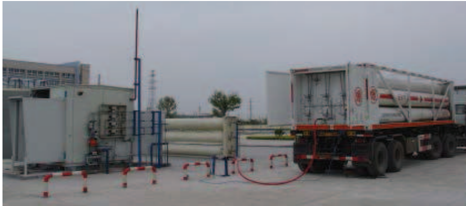
Εικόνα 4.4 Πλήρωση κινητών δεξαμενών με cng
