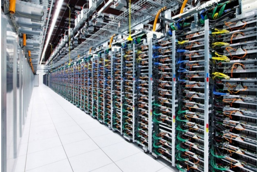
Σχήμα 1.5 :“Κέντρο Δεδομένων : Mayes County”
