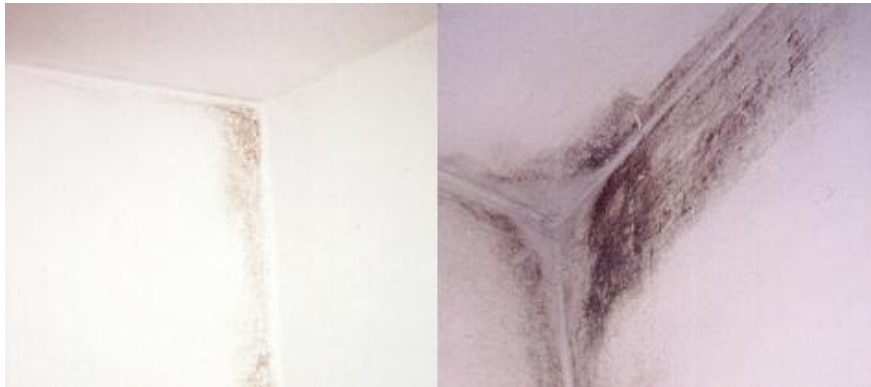
Εικόνα 2.11: Υγρασία στη σύνδεση της τοιχοποιίας με την πλάκα ορόφου λόγω ύπαρξης θερμογέφυρας.
