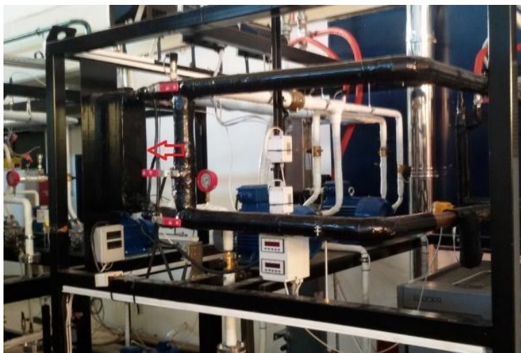
Εικ. 2.7. Ατμοποιητής στο κύκλωμα ORC της εγκατάστασης
